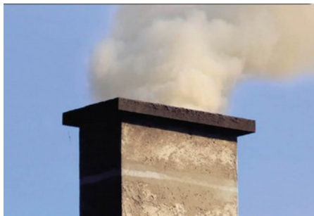
Slika 13; Temnejši ali temen gost dim na vrhu dimnika je pokazatelj zelo slabega zgorevanja (Vir: www.richtigheizen.at )
